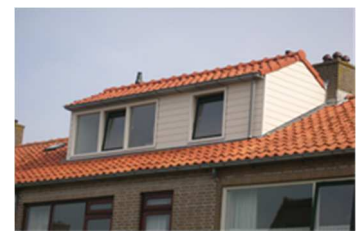
Nokverhoging alleen door doortrekken van voordakvlak waardoor de nok verhoogd en naar achter verschuift
